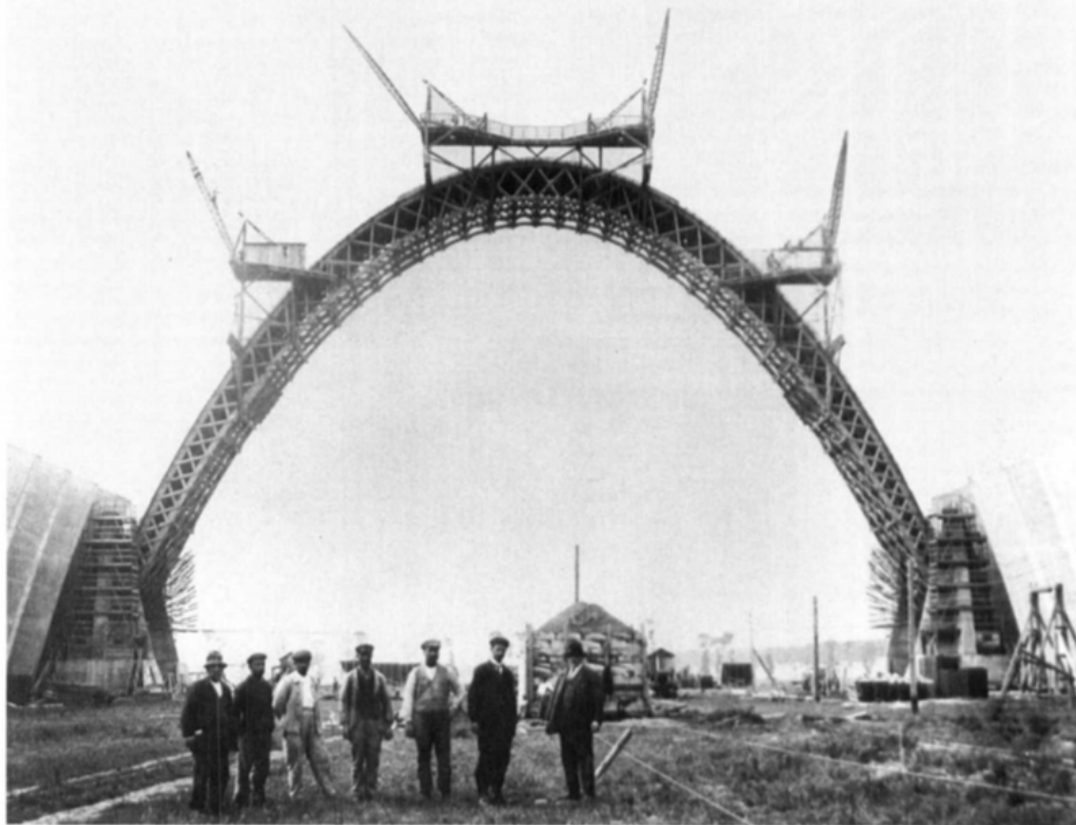
Hangar per dirigibili in cemento a Orly che misurano 90 m di luce x 300 m di lunghezza x 53 m di altezza e le volte in cemento in costruzione a Orly, vicino a Parigi nel 1923, progettati da Eugène Freyssinet
