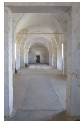
Fig. 16. Vista di una delle grandi stanze voltate un tempo luogo di lavoro per la manifattura del tabacco. (Foto di A. Capanna, 2016)
