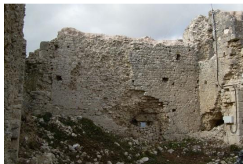
Fig. 4- La disgregazione muraria osservata sulle pareti interne del recinto (foto di Aldagisa Donatelli, 2010)
