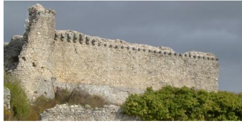
Fig. 6- Le lesioni inclinate visibili sul fronte sud-est (foto di Aldagisa Donatelli, 2025)
