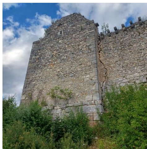
Fig. 5- Il fronte della torre quadrangolare in incipiente ribaltamento verso l'esterno (foto di Aldagisa Donatelli, 2025)
