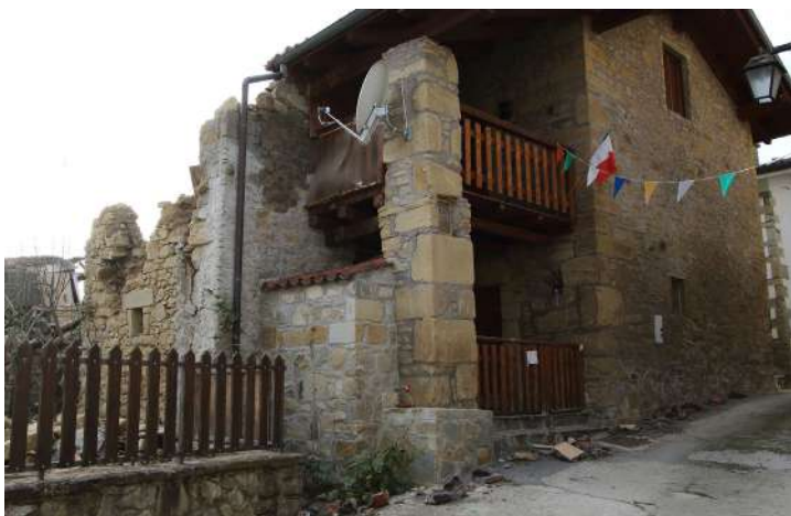
Fig. 4. Dissesto determinato dalla diversa rigidezza tra strutture consolidate e non (foto M. Agostiano).
