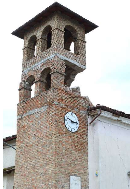
Fig. 6. Dissesti imputabili alle caratteristiche costruttive e tipologiche dell’edificio (foto M. Agostiano).
