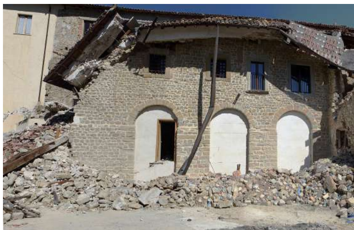
Fig. 2. Dissesto causato dalla pesante copertura in c.a. realizzata su murature scadenti o scarsamente rigide (foto M. Agostiano).
