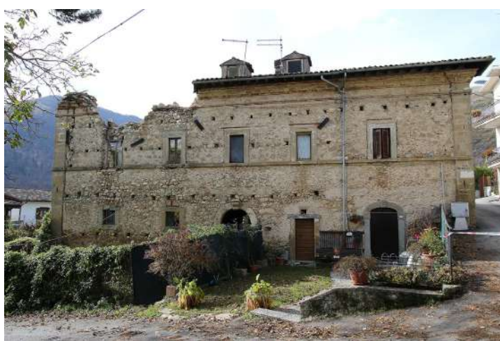
Fig. 3. Dissesto prodotto da scarsa efficacia delle tirantature per le caratteristiche costruttive delle murature o dei relativi ancoraggi (foto M. Agostiano).
