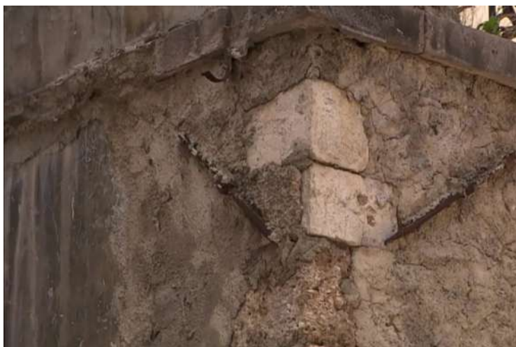
Fig. 10. Murature collegate con catene a seguito dell'intervento di consolidamento effettuato dopo il terremoto del 1997 (foto D. Concas).
