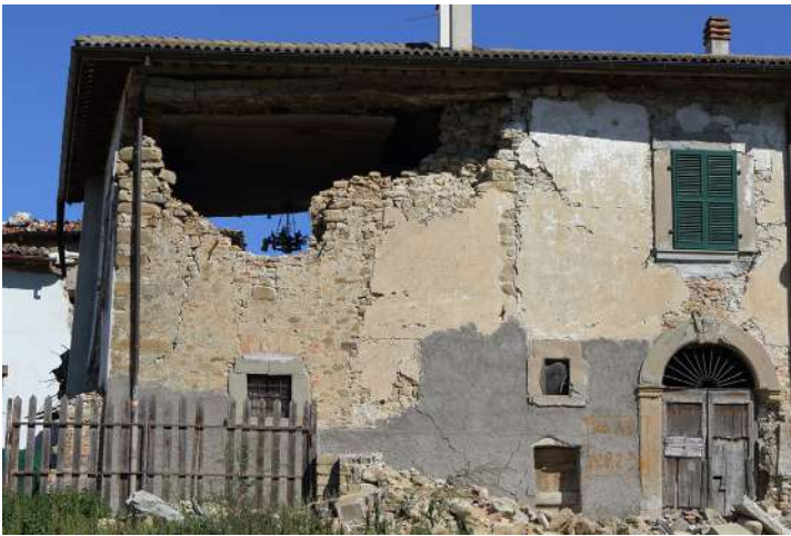
Fig. 5. Dissesto dovuto alla scarsa qualità delle murature per caratteristiche costruttive e dei materiali o alla faticanza (foto M. Agostiano).
