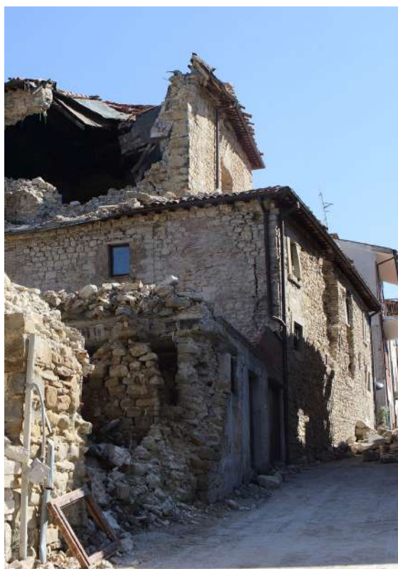
Fig. 7. Murature deboli a causa delle caratteristiche costruttive oppure dei materiali adoperati o del loro stato di conservazione (foto M. Agostiano).
