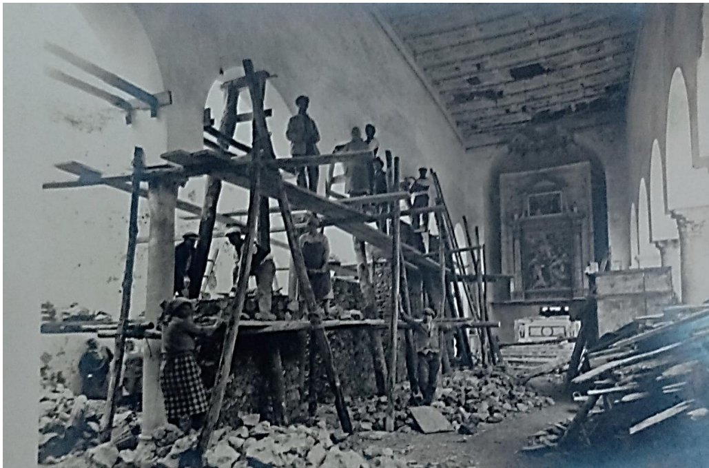
Fig. V.3.6.2. La chiesa della SS. Annunziata di Minuta durante i lavori di restauro del 1929 (Napoli, Castel S. Elmo, Archivio fotografico del Polo Museale della Campania, sn).
