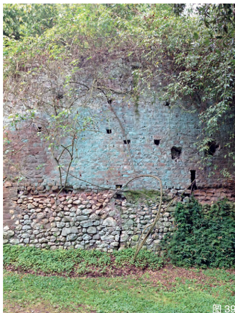
图38 圣比亚乔教堂墙体上使用波尔多混合液喷洒留下淡蓝色痕迹
