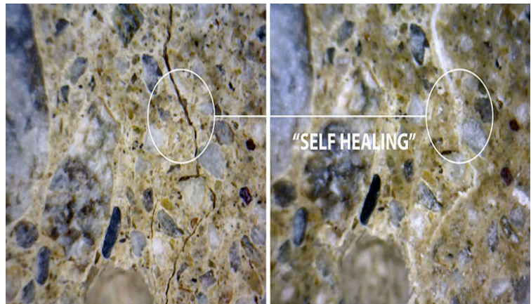
Figura 11 - Il prodotto PENETRON® prima e dopo l'applicazione in una fessura presente in una prova di manufatto cementizio. Fonte: Federbeton
