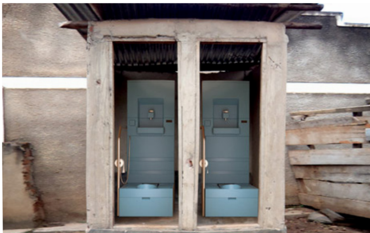
Figura 100: Retrofit di un vecchio bagno con Blue Diversion Toilet in India
