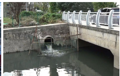
Figura 6: Le fognature domestiche vengono scaricate direttamente nel fosso, 2019.
