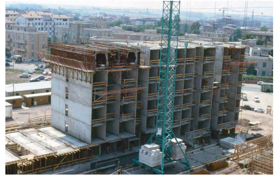
Fig.9: Laurentino, Roma: Edilizia industrializzata con casseforme tunnel e componenti secondari prefabbricati. Successione delle fasi; il prodotto di quindici giornate di lavoro. Fondo Pietro Barucci
