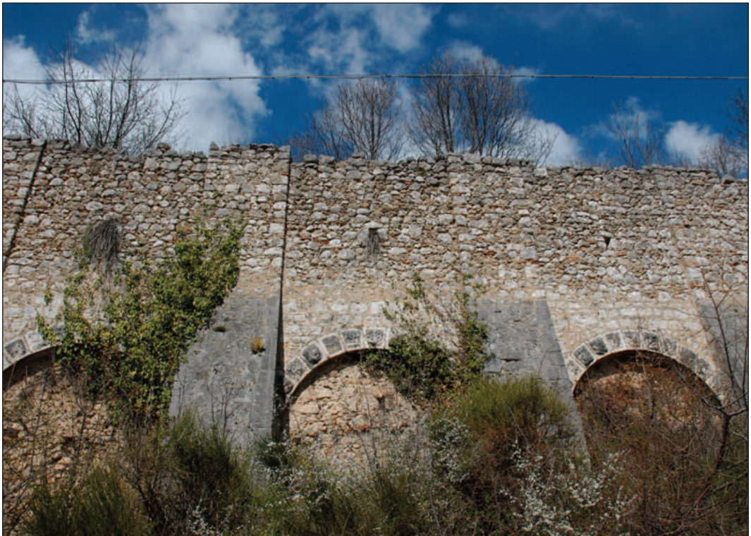
Figura 5. Il poderoso muro di contenimento con arcate di rinforzo e contrafforti (foto Più Studi Architettura, 2008)
