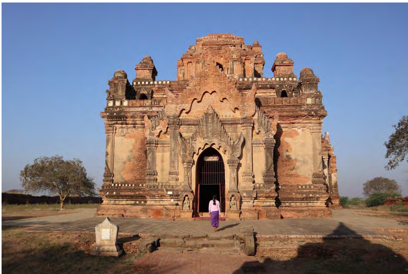
4: Uno dei templi buddisti visitato dai fedeli. Si notano le reintegrazioni murarie e dell'apparato decorativo, ma anche la perdita del sikhkhara probabilmente in seguito al recente terremoto del 2016 (foto © Salvo).
