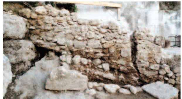
Fig. 110. Dettaglio del parapetto con frattura verticale
