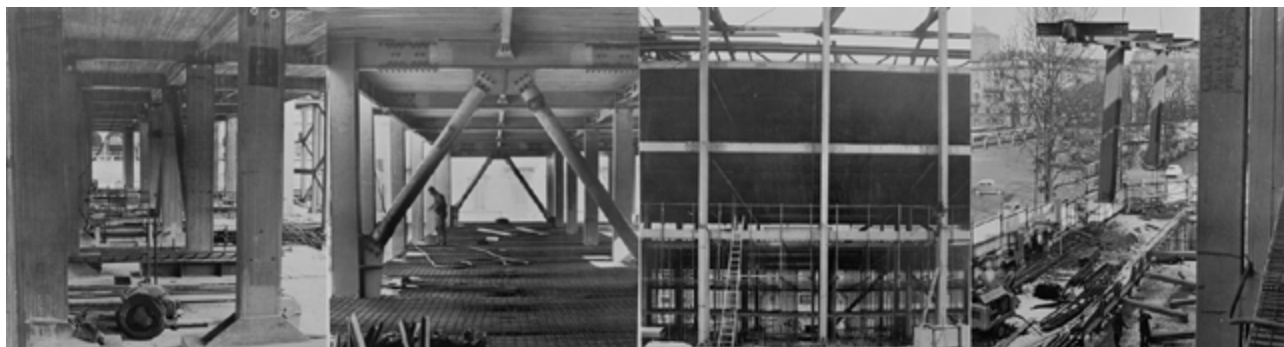
Fig. 2. In sequenza: basi delle colonne dei telai intermedi e di controvento dello scheletro d'acciaio; particolare delle diagonali dei telai di controvento che sono in profilati anulari e che sono state assiemate mediante bullonatura in opera; vista frontale delle varie fasi del montaggio (montaggio, ossatura, solai e getto solette); sollevamento della trave principale assiemata a piè d'opera. Foto d'epoca custodite negli archivi personali di Domenico Morelli e Tullio Finzi - © 2020, Rielaborazione degli autori.
