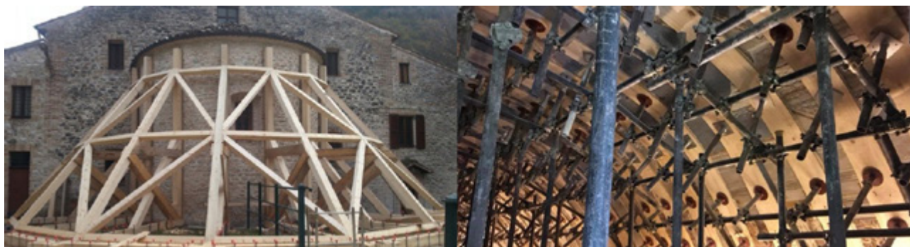
Fig. 5. La messa in sicurezza dell'abside e la puntellatura della volta ©2018, G. Alessandrini.
