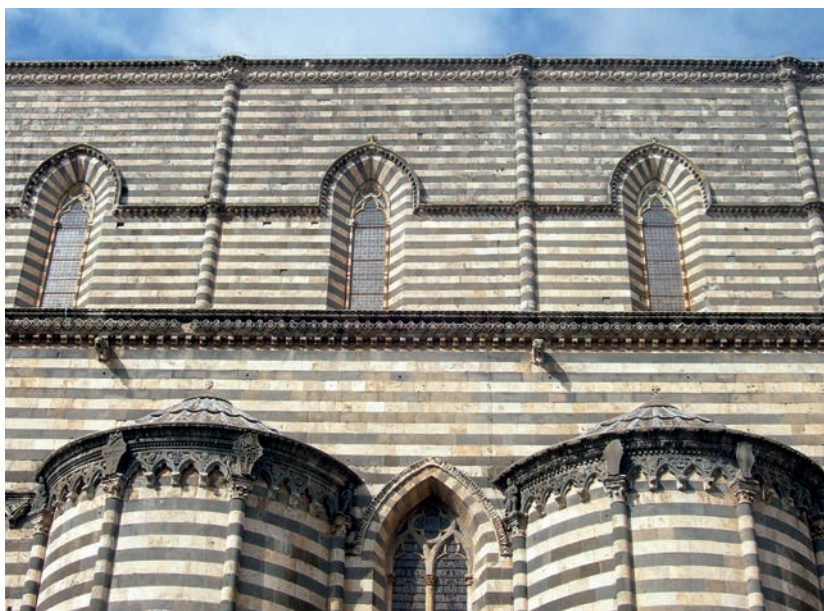
Fig. 6. Duomo di Orvieto, stato della pulizia dei paramenti esterni, lato destro, febbraio 2011.
