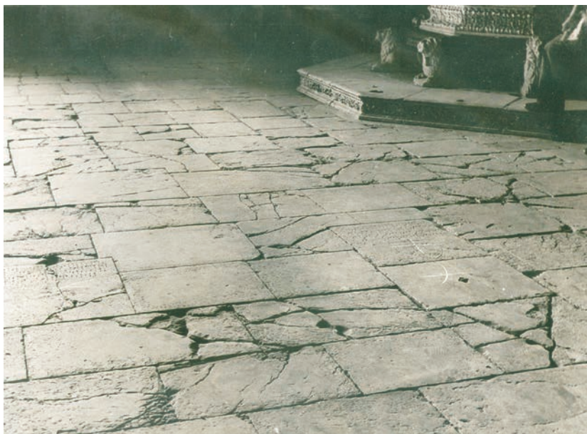
Fig. 14. Duomo di Orvieto, navata centrale. L'ammalorato pavimento originario prima dell'intervento sostitutivo del 1954.
