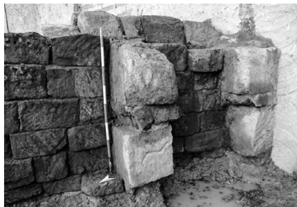
Fig. 8. Acquedotto. Ammorsatura in blocchi di tufo rinvenuta all'estremità ovest del pozzo 3.2. Blocco di tufo giallo con marchio di cava.
