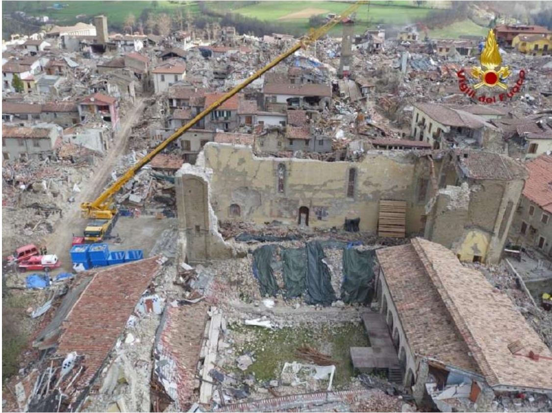
Figura 3.2.10: Foto da drone della Chiesa di S. Francesco ad Amatrice, opere di messa in sicurezza nell'aprile del 2017. (vigilfuocotv.it)(data ultima consultazione 20/07/20)
