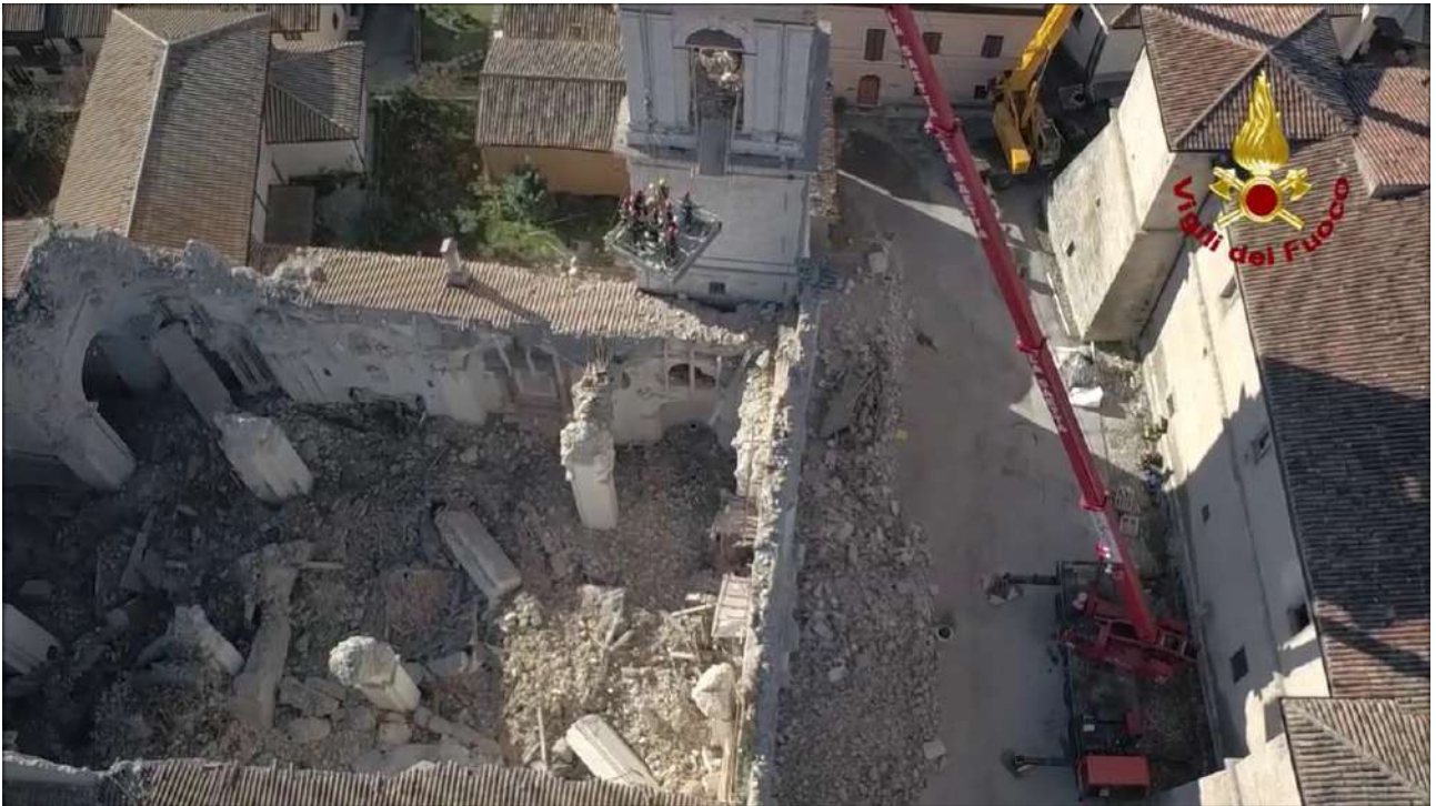
Figura 3.2.22: Foto da drone delle condizioni del Duomo di Santa Maria Argentea di Norcia dopo la scossa di terremoto del 30 ottobre 2016. ( vigilfuocotv.it )(data ultima consultazione 20/07/20)
