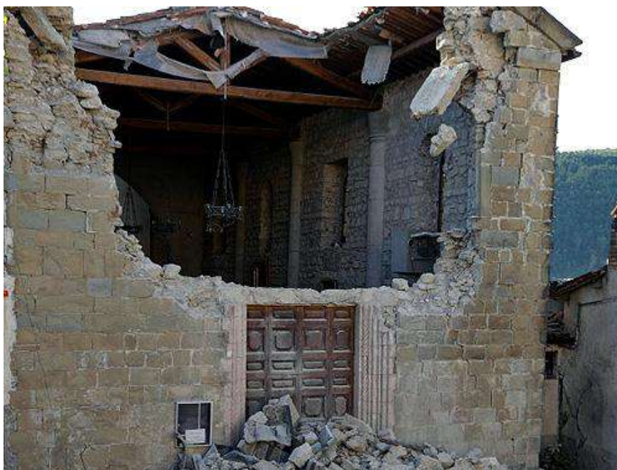
Figura 3.2.14: Condizioni della chiesa di S. Francesco ad Accumoli a seguito della scossa di terremoto del 24 agosto 2016. Con gli eventi sismici successivi la chiesa è completamente crollata.( www.comune.accumoli.ri.it )(data ultima consultazione 20/07/20)
