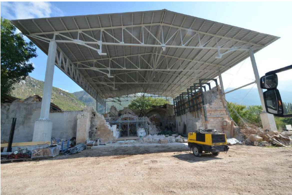
Figura 3.2.23: Resti della chiesa di San Salvatore in Campi di Norcia, al di sotto della struttura a protezione delle macerie realizzata dall'ISCR per permettere il recupero dei frammenti degli affreschi. ( sansalvatoreincampi.beniculturali.it )(data ultima consultazione 20/07/20)
