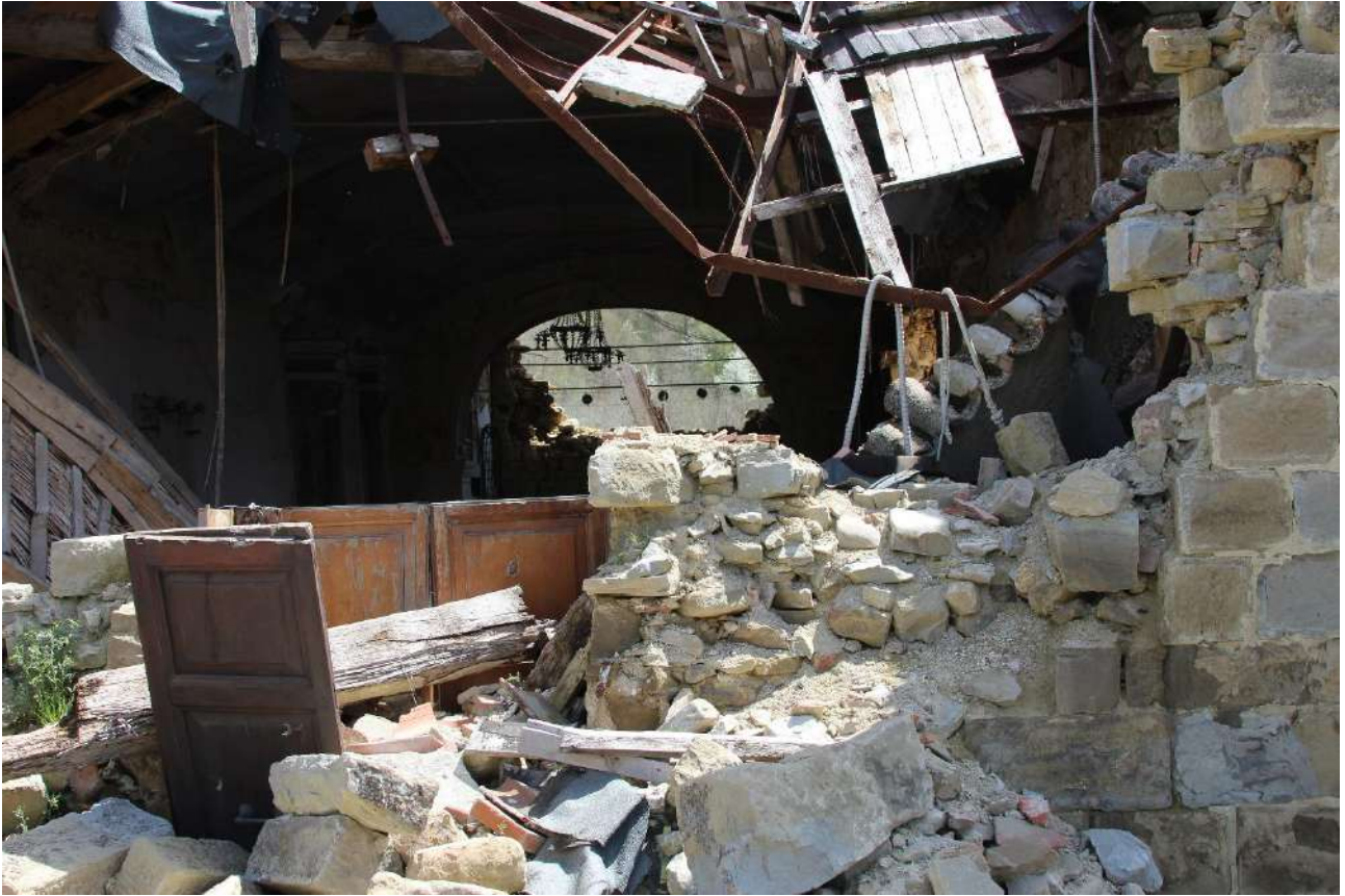
Figura 4.26: Scai, Chiesa di San Sebastiano, facciata crollata, si noti come il paramento interno ed esterno siano il primo in muratura in bozze, il secondo in pietra squadrata
