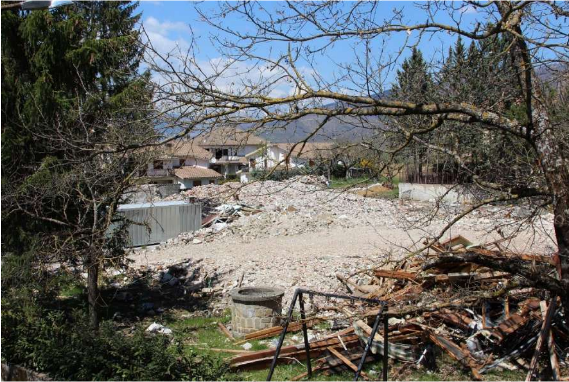
Figura 4.4: Amatrice, resti della demolizione di abitazioni storiche gravemente danneggiate dal sisma, Aprile 2018
