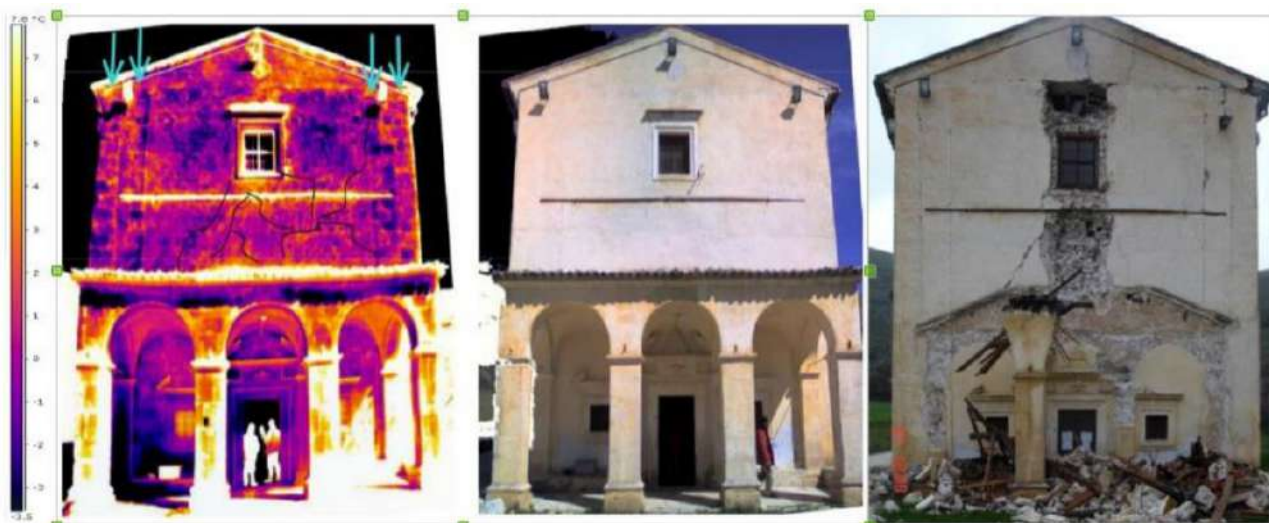
Figura 2.1.4: chiesa di Santo Stefano di Sessanio (AQ). A sinistra: Immagine termografica rilevata nel marzo 2009 con il sistema IRpano. Si può notare la differenza della tessitura muraria della facciata e dei cantonali. Evidenziato il quadro fessurativo sub superficiale presente nella zona centrale al di sotto della finestra. Al centro: Immagine fotografica acquisita contestualmente alle riprese termografiche con il sistema IRpano, si noti come le criticità evidenziate nell'immagine in falso colore non siano apprezzabili ad occhio nudo. A destra: chiesa di Santo Stefano di Sessanio dopo la scossa di terremoto del 6 Aprile 2009. Il quadro dei dissesti riflette in buona parte le vulnerabilità già evidenziate in termovisione, e dall'analisi storico-costruttiva. Si noti non solo il crollo del nartece e l'espulsione della muratura che presentava già un quadro fessurativo molto ramificato in quella zona, ma anche l'apertura delle lesioni ai lati della facciata che ripercorrono esattamente l'andamento dei due paramenti murari non ammortati (CADELANO ET AL, 2015) .
