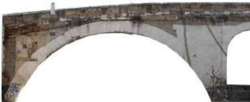
Fig. 1. Ponte Fabricio, prospetto attuale a monte. Fotoraddrizzamento, dettaglio (elaborazione di Carlo Inglese).
