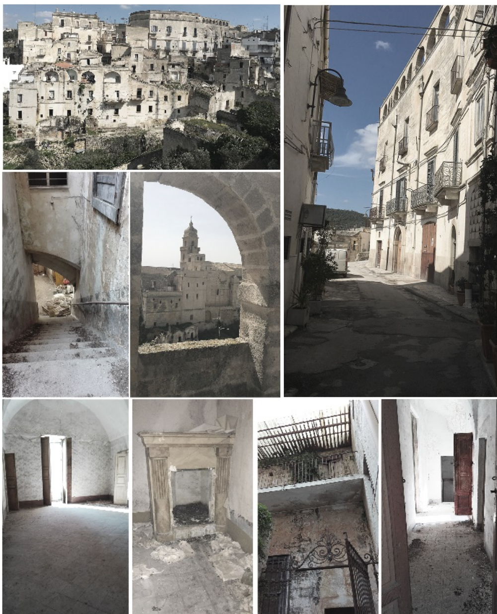
Figura 3 | Stato di fatto del Rione Piaggio e di Palazzo Calderoni Marchetti: degrado e abbandono. Fonte: Ripa S.M., 2017
