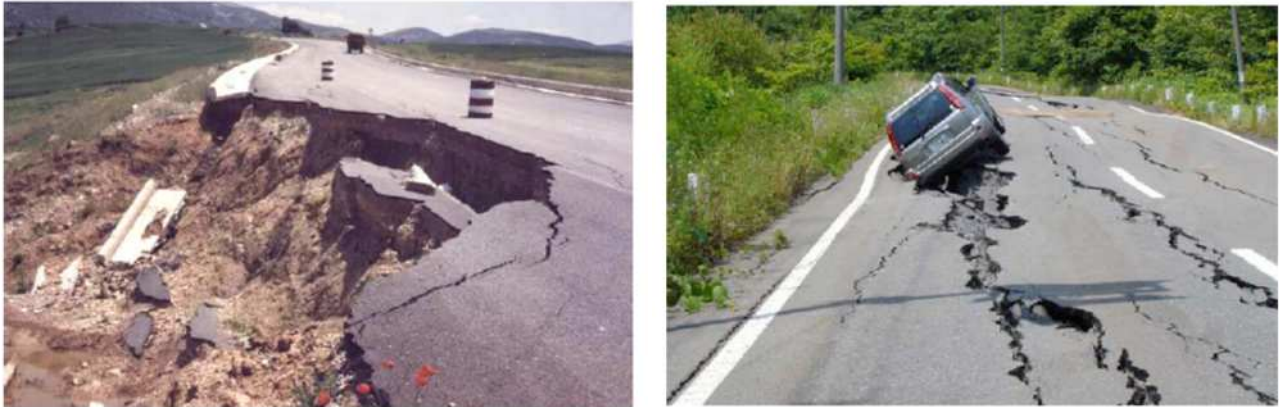
Figura 43 a) danneggiamento di un rilevato – terremoto Kozani (Gb) 1995 b) Danneggiamento rilevato terremoto Miyagi-Nairiku (Japan) 2008
