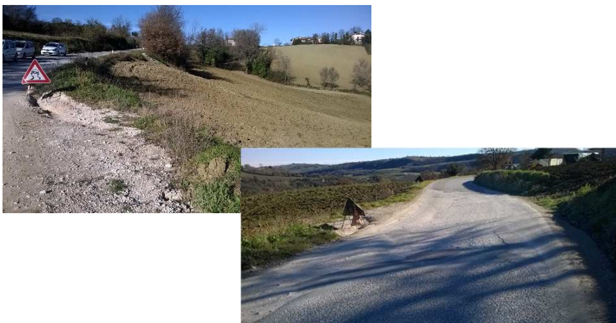
Figura 87 Scivolamento corpo stradale verso valle per attivazione di un fenomeno franoso sul versante di valle sulla SP59
