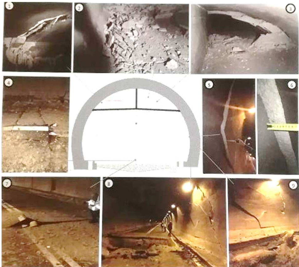
Figura 93 danneggiamento galleria San Benedetto (foto rivista Gallerie n 123 n° settembre 2017)
