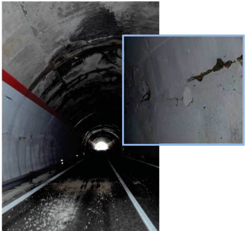
Figura 91 gallerie – danneggiamenti minori
