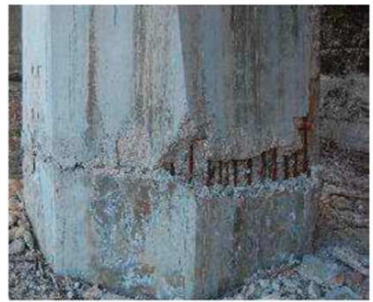
Figura 73 Espulsione del copriferro sulle pile
