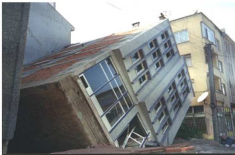
Figura 32 Edificio ribaltato in Adapazari a causa di fondazioni indebolite / liquefatte Report on 1999 kocaeli and düzce (turkey) earthquakes - Mustafa Erdik
