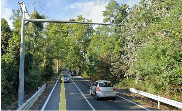
Figura 35 - Stazione 1046 – Centraline su portale (S.S.4)
