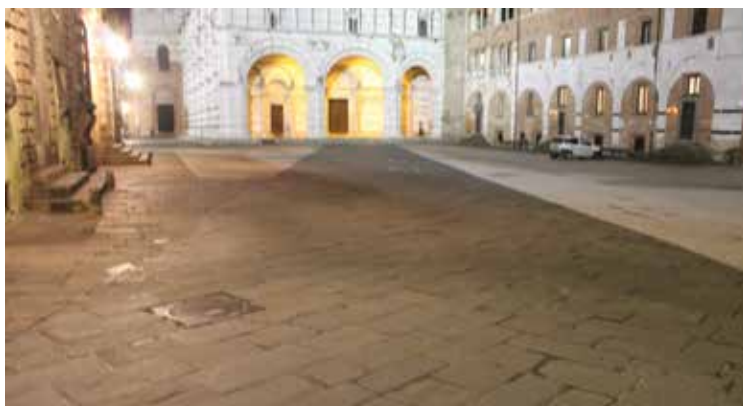
Fig. 383 Dettaglio della pavimentazione sconnessa realizzata in basoli locali, nella piazza del Duomo.
