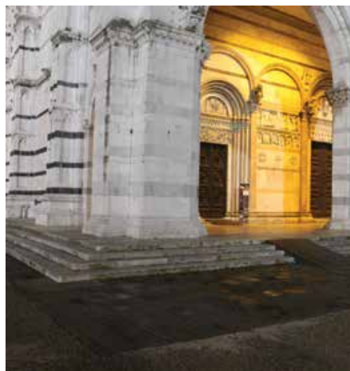
Fig. 382 Dettaglio della pedana di accesso non a norma, per accedere all'interno del Duomo
