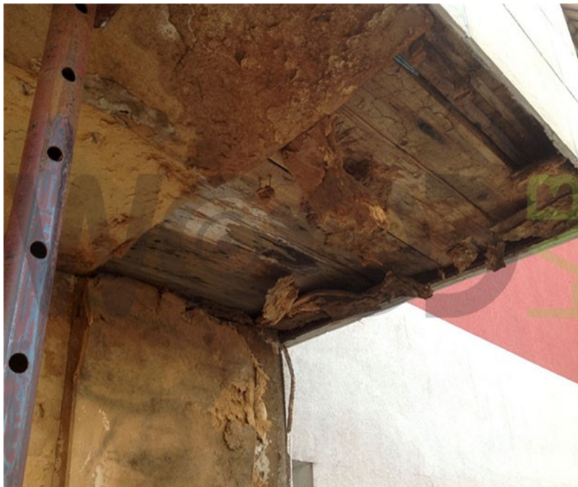
Figura 93 Elementi di parete perimetrale verticale e di chiusura orizzontale su spazi aperti degradate a causa di infiltrazione superiore d'acqua ("BLOG - Durabilità degli edifici in legno: quando i danni possono essere evitati WoodLab," n.d.)
