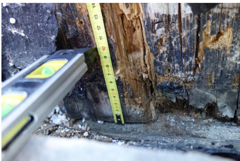
Figura 87 Marcescenza alla base dei pannelli in legno, causata da acqua stagnante (“Edifici in legno: quanto durano? Ergodomus,” n.d.)
