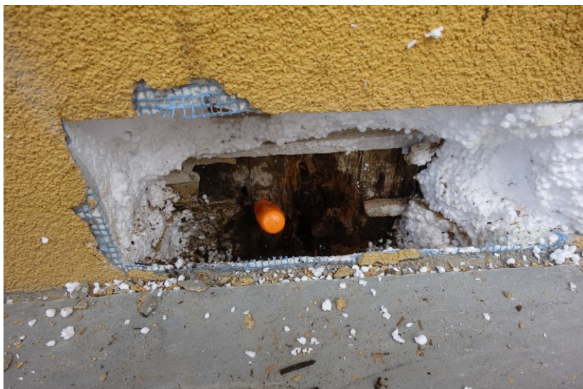
Figura 86 Degrado del pannello in Xlam per imbibizione di acqua. Il legno si trova ad una quota inferiore della soglia esterna (Merotto, 2017a)
