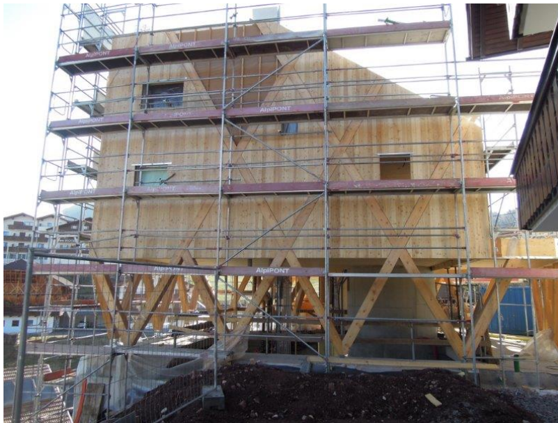
Figura 117 Foto di cantiere dell'edificio del Caso Studio 11. In alto si vede il telo di copertura dei pannelli isolanti sottostanti e i montanti in legno
