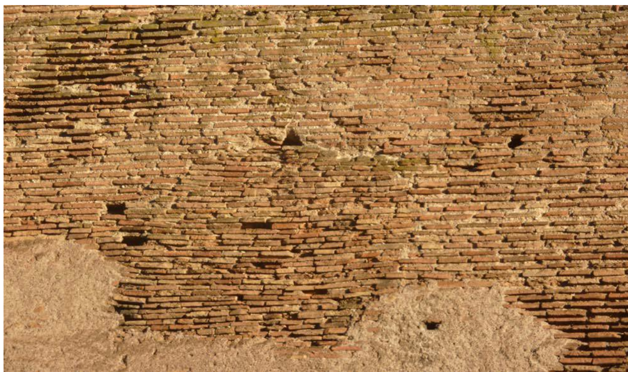
Figura 2.9 Settore Porta Flaminia – Porta Pinciana, tra le torri A22 e A23. Nella zona centrale è evidente un’area in cui i mattoni sono disposti in modo molto ravvicinato, con giunti di malta ad andamento ondulato, dimezzati rispetto a quelli della muratura circostante. Foto D’Ippolito.
