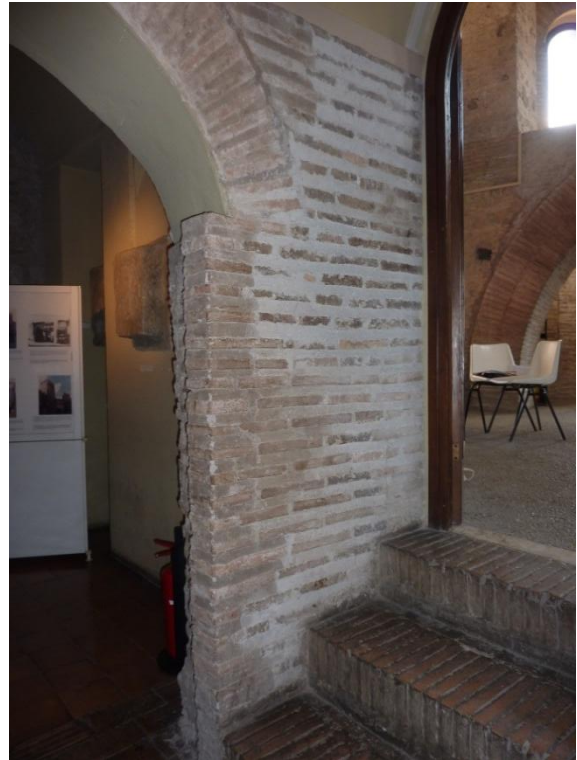
Figura 7.20 Porta Appia, secondo piano, strutture corpo scale occidentale, fianco est dell'apertura ( EA 289 ) di collegamento tra l'ambiente B2 e la torre circolare. Foto D'Ippolito.
