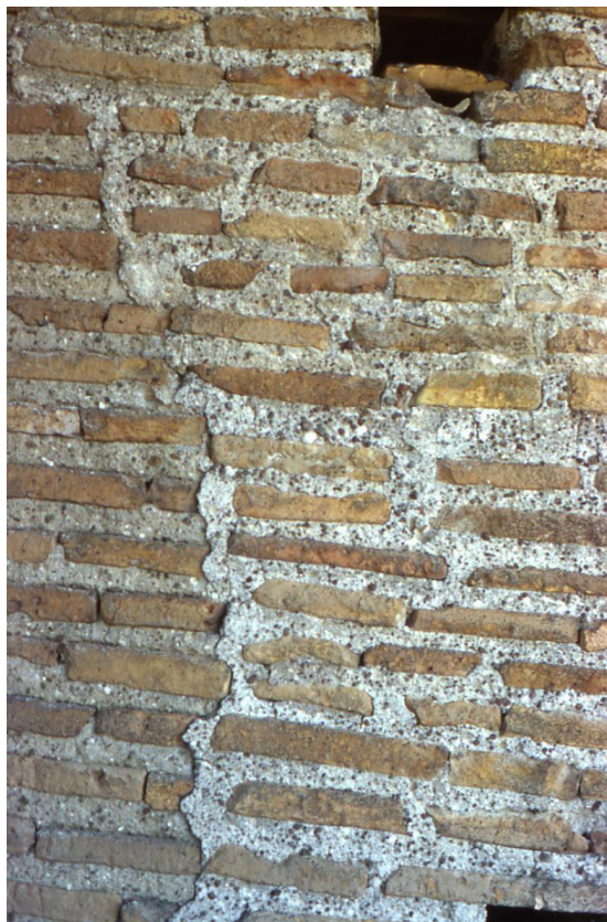
Figura 6.13 Porta Appia, torre occidentale, prospetto ovest, paramento della parte circolare all'altezza del terzo piano, in corrispondenza dell'addossamento della muratura di terzo periodo di VIII-IX secolo ( USM 140 , a destra) sulla muratura onoriana di secondo periodo. Foto D'Ippolito.
