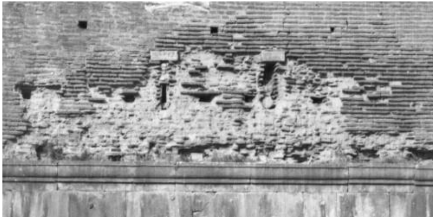
Figura 3.5 Porta Appia, torre orientale, bastione quadrangolare, lato est, primo piano (particolare della foto in figura 3.12). La foto evidenzia la presenza di feritoie sormontate da architravi lapidei. Foto Istituto Luce L00007859 (1870-1911).
