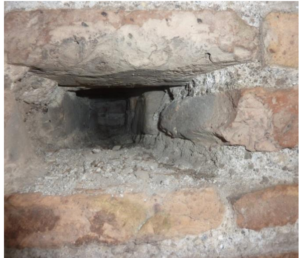
Figura 8.6 Torre M6, particolare che inquadra una buca puntaia della muratura di Onorio in fondo alla quale è visibile la muratura di Aureliano. Foto D'Ippolito.
