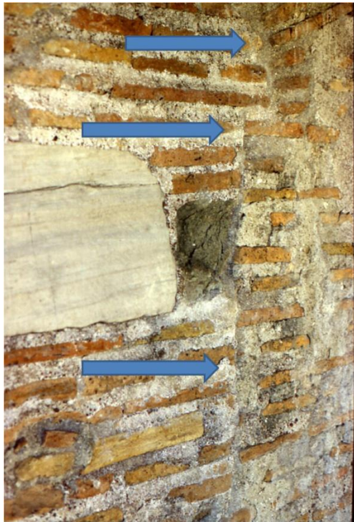
Figura 6.9 Porta Appia, torre occidentale, bastione quadrangolare in laterizi e tufo, lato est, all'altezza del secondo piano, in corrispondenza del tamponamento della finestra EA 45. Foto D'Ippolito.
