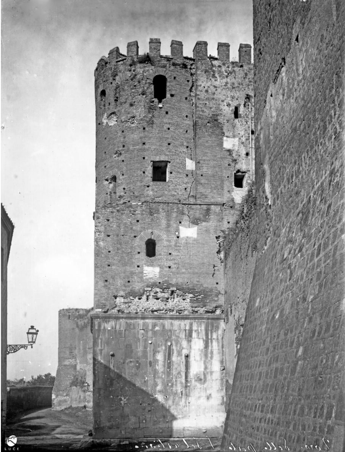
Figura 3.12 Porta Appia, torre orientale, lato est. Foto tra il 1870 e il 1911. Le sagome bianche poste in corrispondenza di vistose fessurazioni sono spie per il controllo del progredire o meno del distacco. Foto Istituto Luce L00007859.
