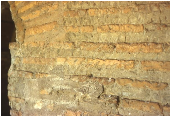
Figura 6.3 Porta Appia, torre occidentale, bastione quadrangolare laterizio, lato est, in corrispondenza dello stipite nord della finestra EA 122 del secondo piano. Foto D’Ippolito.
