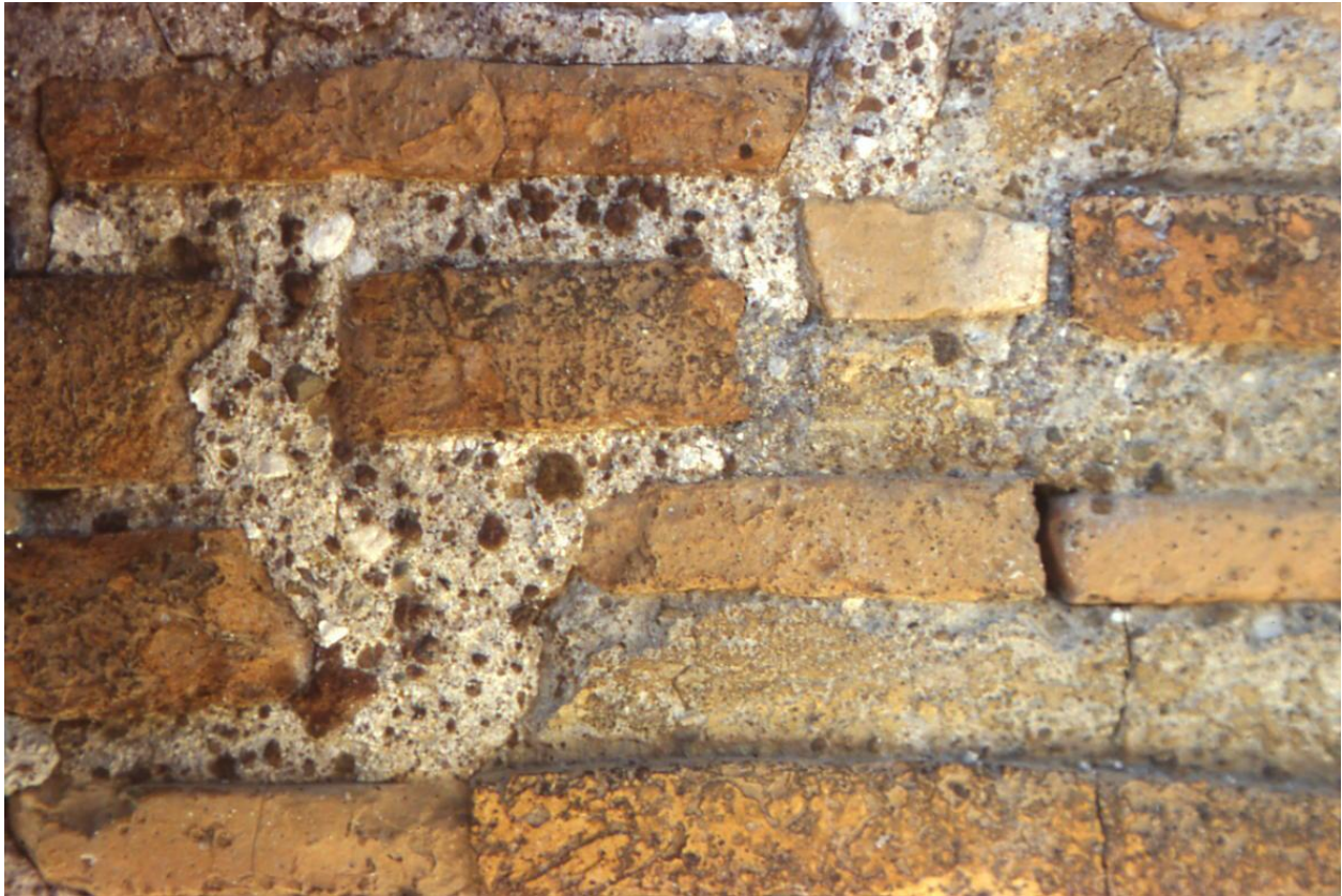
Figura 6.11 Porta Appia, torre occidentale, prospetto est, paramento della parte circolare all'altezza del terzo piano, in corrispondenza del punto dell'addossamento della USM 140 di VIII-IX secolo sulla USM 112 di V secolo. Quest'ultima è caratterizzata da una malta più grigiastra, a matrice più mista, in gran parte nascosta dalla patina ocrea sulla superficie allisciata dei giunti orizzontali. Il punto raffigurato nella foto è individuato negli elaborati grafici (allegati 4.1, 4.2) e nel file vettoriale (allegato. 6.1) dalla nota tecnica 16. La zona inquadrata si trova tra le finestre EA 130 ed EA 109 . Foto D'Ippolito.
