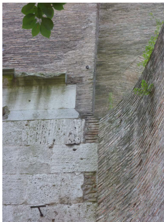
Figura 5.26 Porta Appia, addossamento della parete esterna del braccio occidentale della controporta alla parete nord della porta. Foto D'Ippolito.
