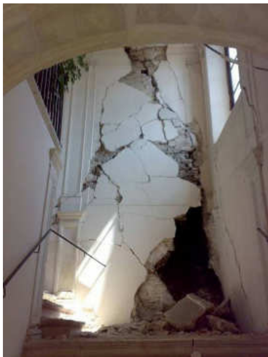
Fig. 8. Un esempio di vulnerabilità causata da manomissioni incontrollate, eseguite per finalità funzionali: si tratta di un edificio aquilano in cui, per ricavare una canna fumaria, sono stati tagliati alcuni archi di scarico realizzati all'interno dello spessore murario e non visibili all'esterno. La manomissione ha introdotto una debolezza che è stata evidenziata dal sisma con i danni visibili nell'immagine.
