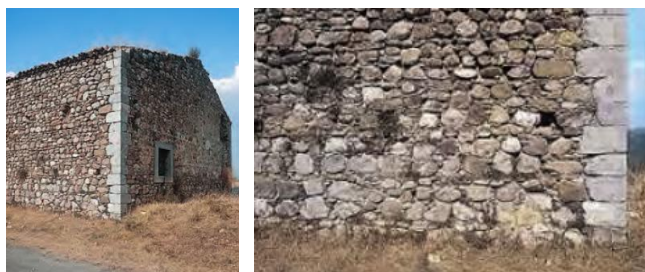
Fig. 1 Un edificio con involucro in muratura lapidea e ammorsature d'angolo realizzate con grandi elementi squadrati di pietra [Acocella, 2004, p. 105]
