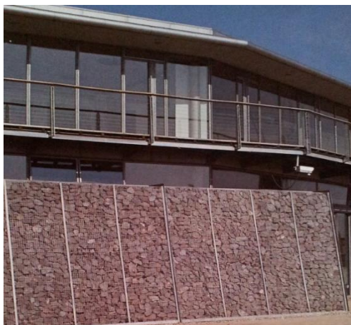
Fig. 141 Il muro a gabbioni della sede del circolo del London Regatta Centre [Dernie, 2003, p. 76]
