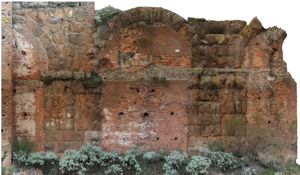
Fig. 68 – Profili irregolari delle tamponature dei fornici che testimoniano un ammaloramento dei piloni già in antico (Ortofoto L. Radicioni).
