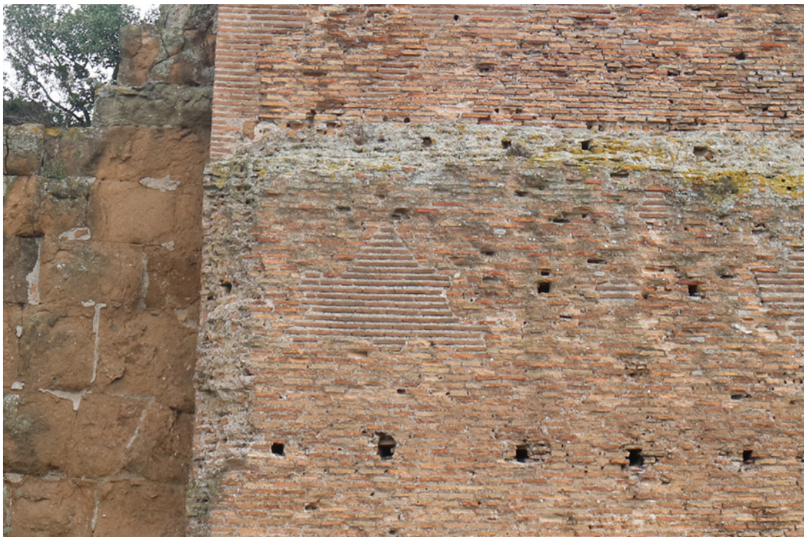
Fig. 59 – Obliterazione della specchiatura di opera reticolata da parte di restauro moderno (Foto L. Radicioni).
