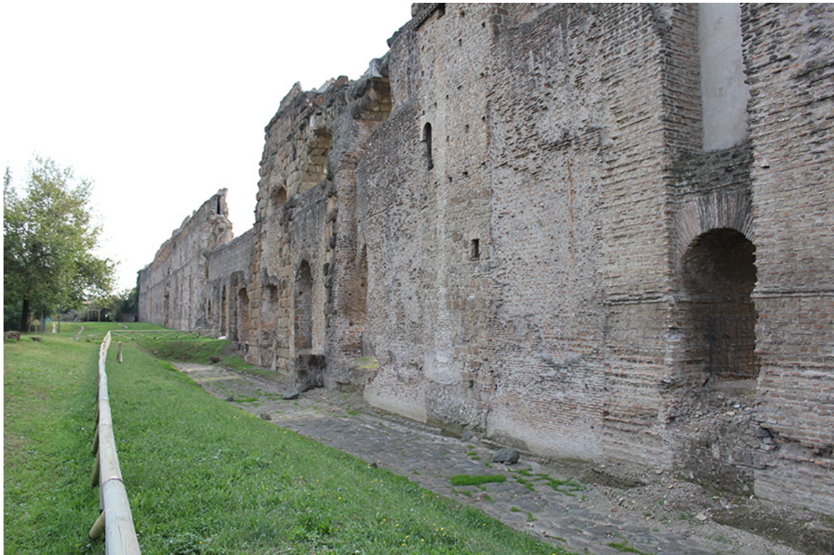
Fig. 11 – Strutture dell’acquedotto di Claudio impostate sul marciapiede O della strada (Foto L. Radicioni).
