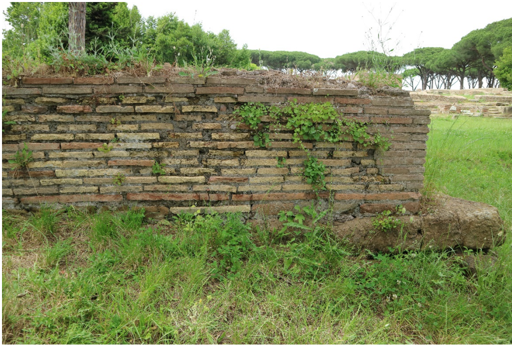
Figura 6: Particolare della porzione meridionale del blocco 1. E' evidente come il muro si imponesse su resti precedenti (in merito al blocco di tufo inglobato nell'angolo vd. capitolo 8).
