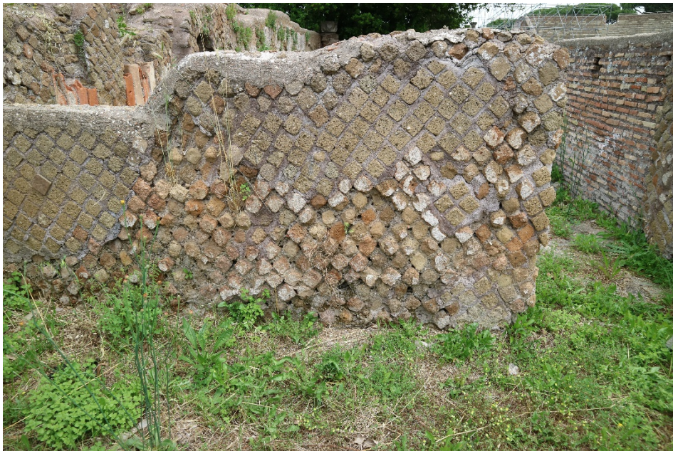
Figura 17: Domus di Apuleio. Integrazione di un muro in opera reticolata attraverso tessere di tufo moderne
