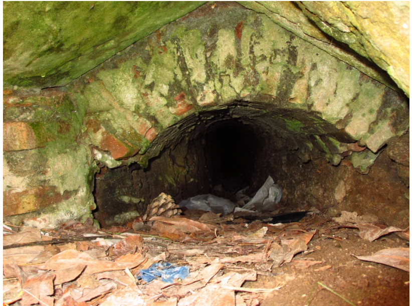
Figura 3: Particolare della fogna coperta da volta a botte che dalla fronte della casa di Apuleio si sviluppava verso il teatro. Si noti come ad essa si addossò la fogna successiva coperta a cappuccina (Foto E. Santucci).
