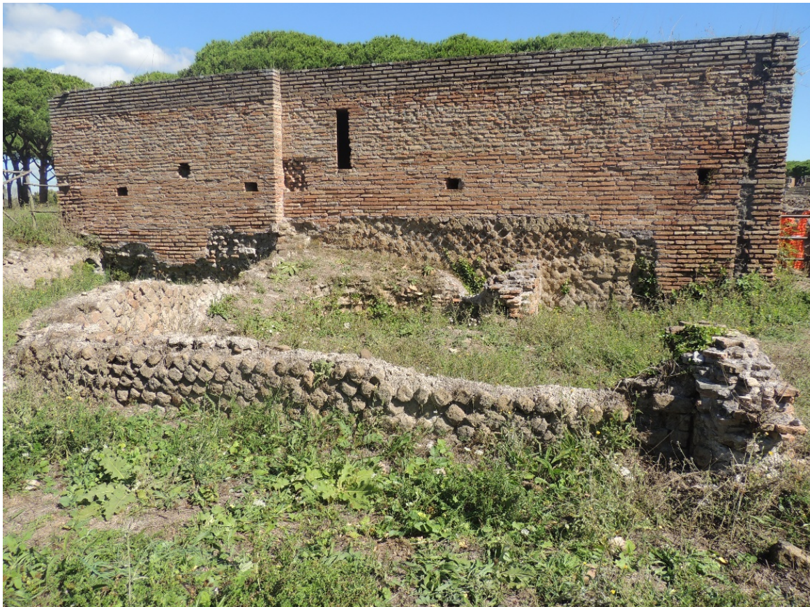
Figura 31: Lato occidentale del Mitreo delle Sette Sfere. Resti di strutture precedenti inglobati nel monumento
