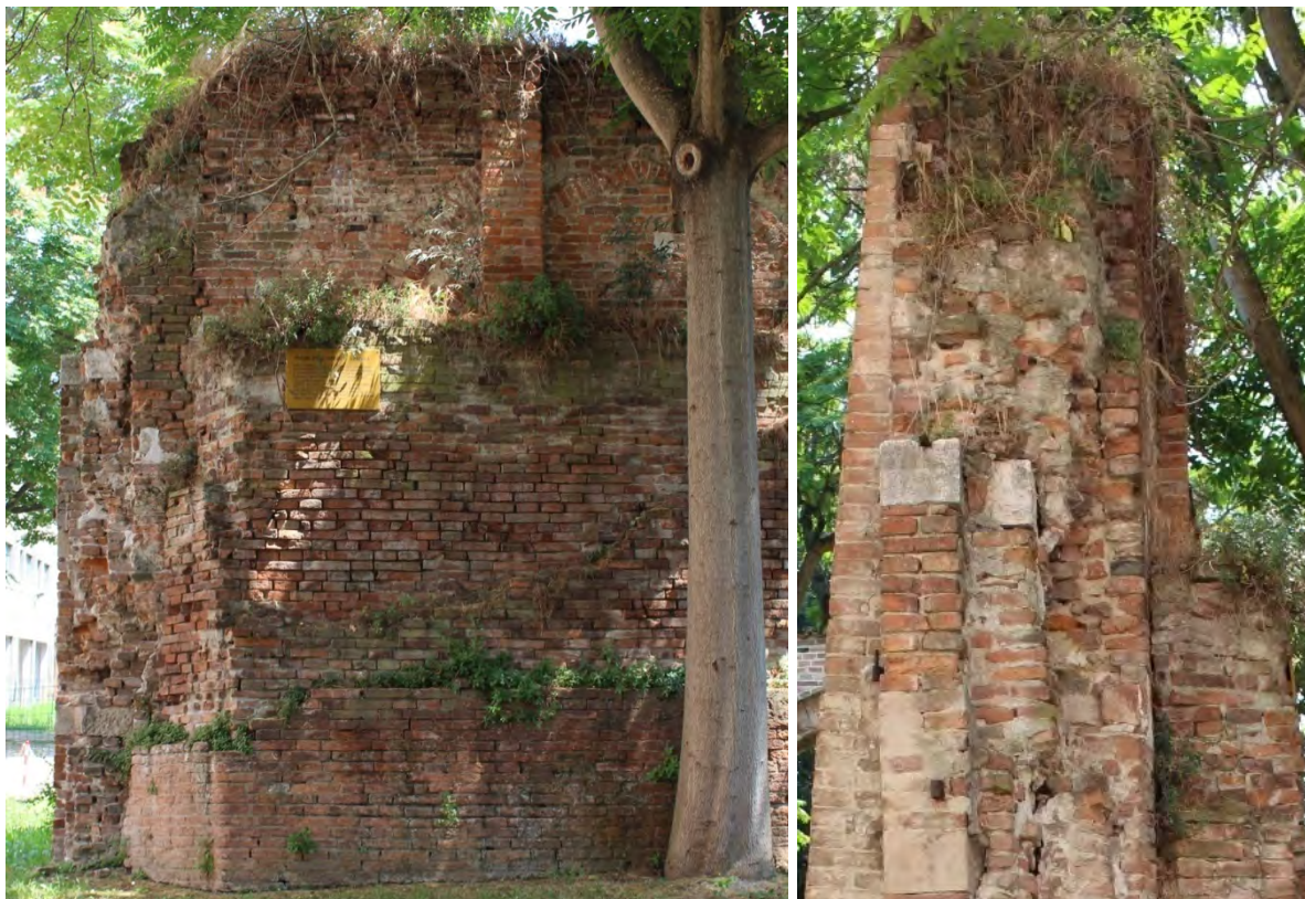
Vista delle murature di quanto resta del prospetto principale della Chiesa d Sant'Andrea
