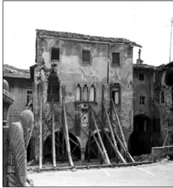
Venzone, effetti del terremoto sull'edificio del Comune medievale, si noti la forma di rottura della finestra, 1976
