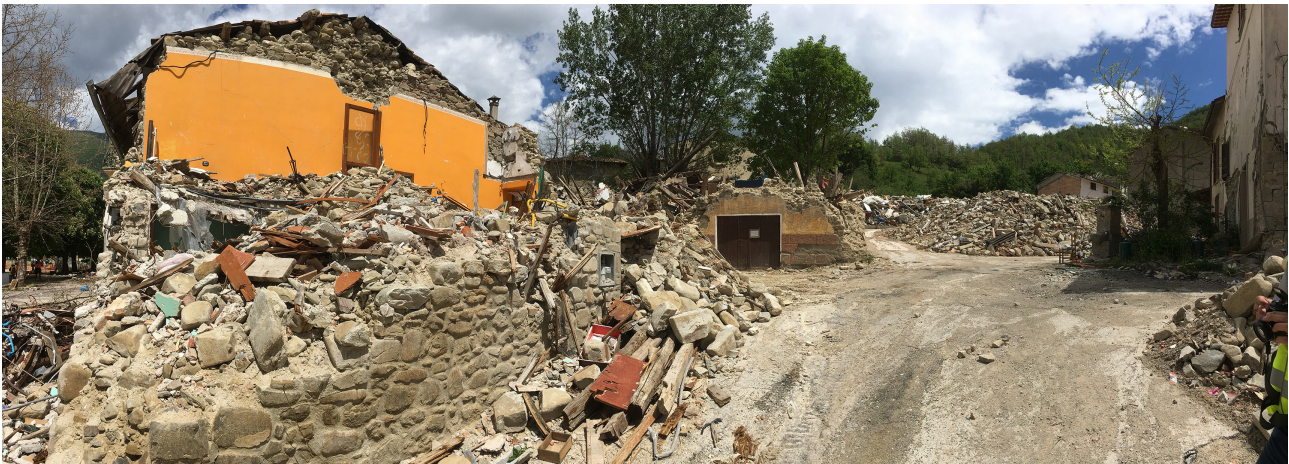
Fig. 1. Comune di Accumoli, frazione di Grisciano dopo la fase di rimozione delle macerie.
