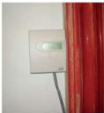
Foto del posizionamento del sensore a parete.
