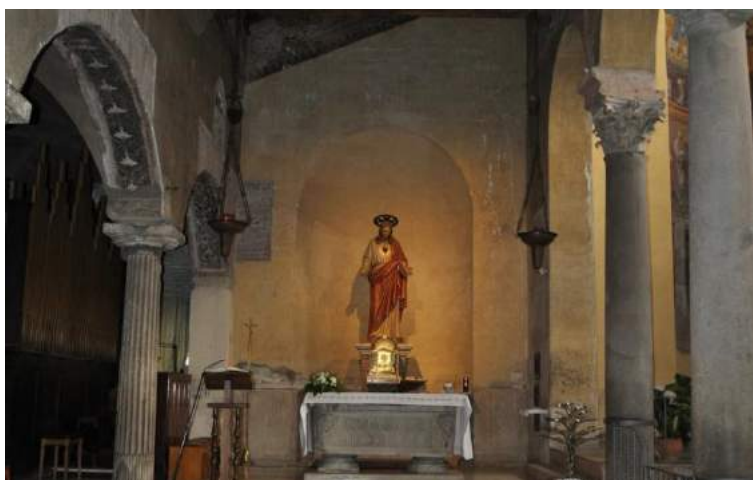
Fig. 13 – Fenomeni di degrado nella parete absidale della navata sinistra
