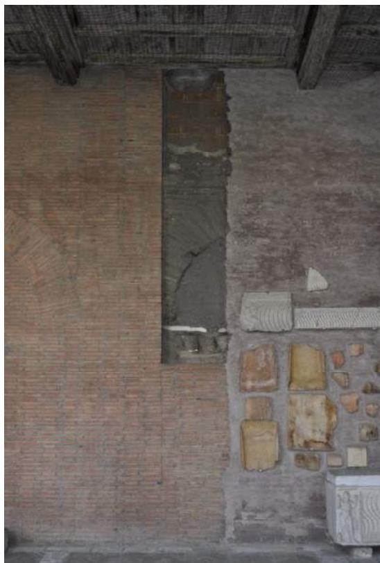
Fig. 16 – Resti dell'arcata a sud del portale di ingresso
