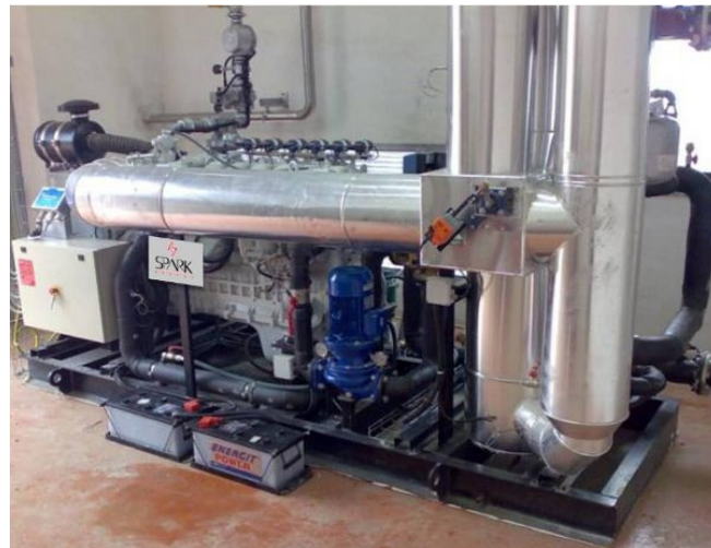
Figura 2:1: Il cogeneratore Spark 140M.
