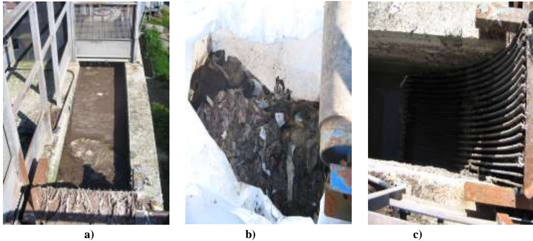
Figura 4.4 - Sistema di grigliatura presso l'impianto di depurazione oggetto dello studio: a) in caso di non funzionamento delle griglie nella vasca di accumulo; b) materiale intercettato nella fase di grigliatura; c) funzionamento normale della griglia a barre
