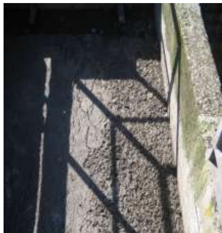
Figura 4.5 - Deoleatore dell'impianto di depurazione oggetto dello studio
