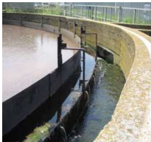
Figura 4.7 - Particolare del sedimentatore secondario dell'impianto di depurazione oggetto dello studio
