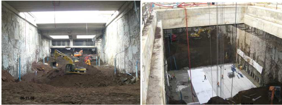
Figura 4-7. Lavori di realizzazione della nuova Linea C della Metropolitana di Roma - Pozzo TBM Malatesta: a) scavo per campioni; b) preparazione del piano di posa per l'immediato getto del solettone di fondo
