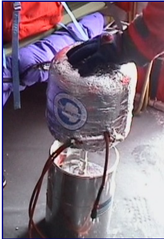
Figura 5: Coibentazione della pompa con materiali plastici speciali e dotazione di cavi di alimentazione per il collegamento con il sistema riscaldante.
