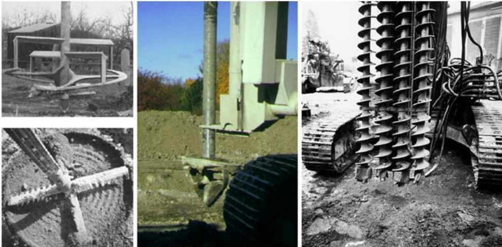
Figura 1.1 - Evoluzione dell'utensile di miscelazione, da quello a singola coclea fino a quello munito di più alberi rotanti con aste dotate di pale o eliche miscelatrici (Massarch and Topolnicky, 2005).
