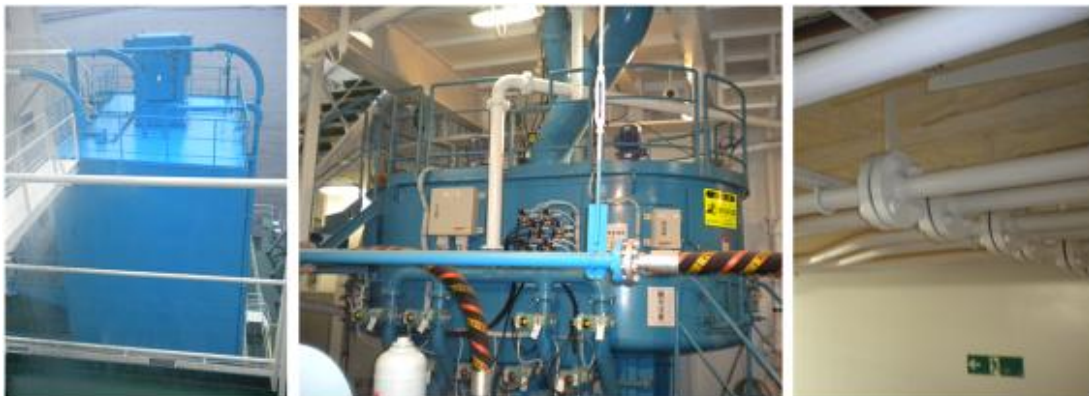
Figura 2.35 - Particolare silos, vasca di raccolta e tubazioni impiegati.
