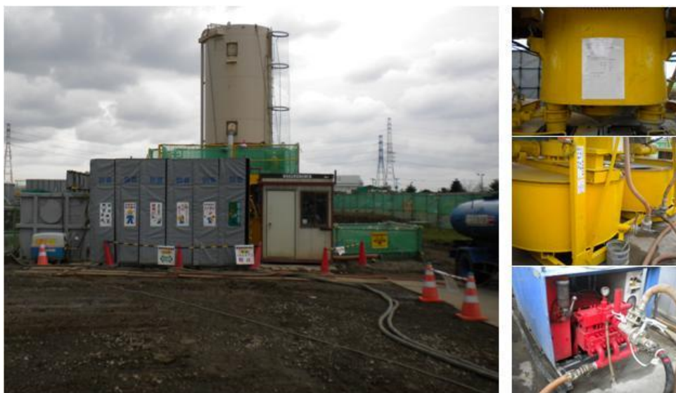
Figura 2.30 - Impianto di produzione della malta cementizia.
