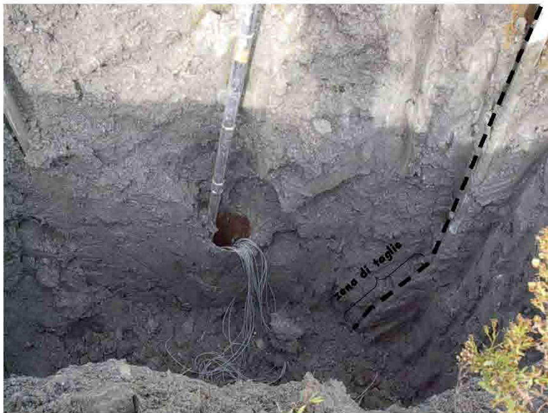
Fig. 3.51. Masseria Marino: all'interno di un pozzo realizzato per il prelievo dei campioni si osserva che un tubo spia in acciaio, ubicato in adiacenza al pozzo, ha subito intense deformazioni da taglio
