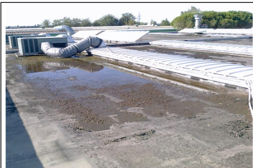
Fig. 217. Esempio di degrado di copertura- edificio industriale con infiltrazioni di acqua e dispersioni termiche
