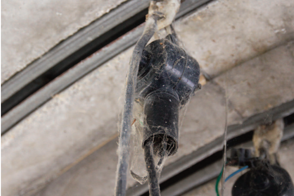
Apparecchiatura, Spazio Esterno, Dettaglio
