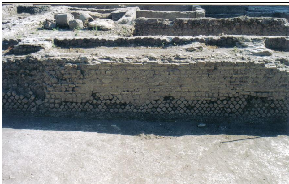
Figura 109. Via Sorelle Marchisio. Particolare del rifacimento dell'ambiente 2 con murature in opera listata (SBAR, Archivio Santolini).
