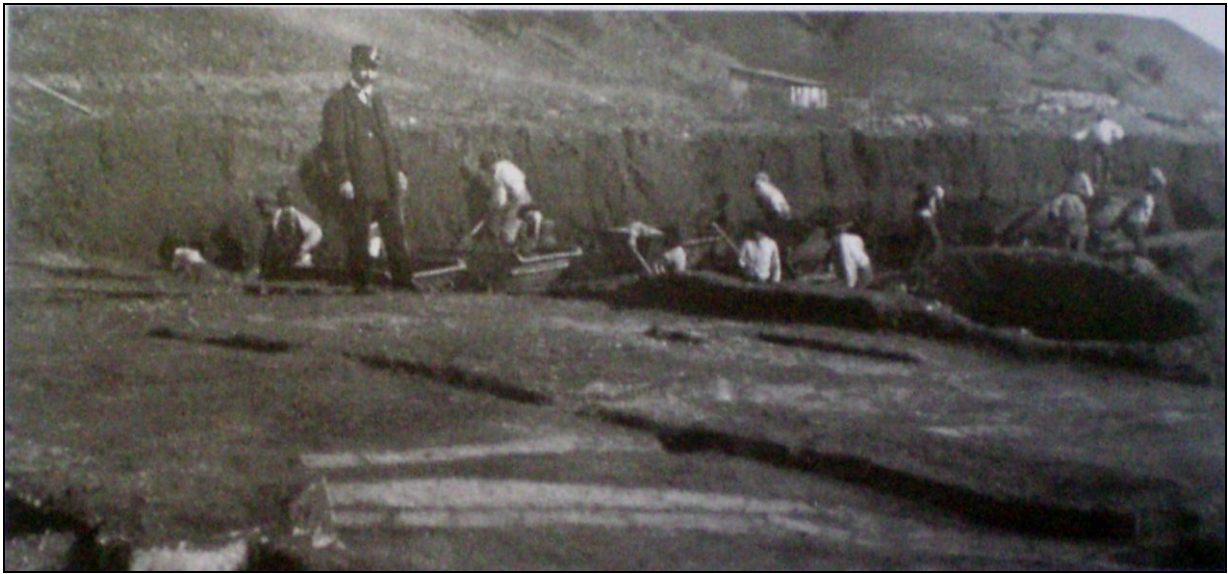
Figura 1. Lavori di sterro eseguiti dal Genio Militare nel fondovalle di Acquatraversa nel 1916-1917 (da VISTOLI 2005).
