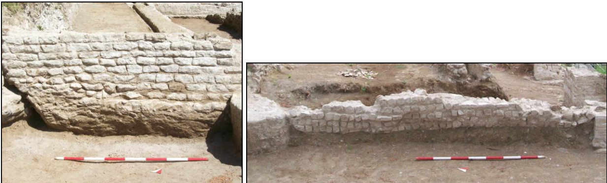
Figura 78. Villa di Lucio Vero. Resti di murature tardo antiche (SBAR, Piazza delle Finanze).
