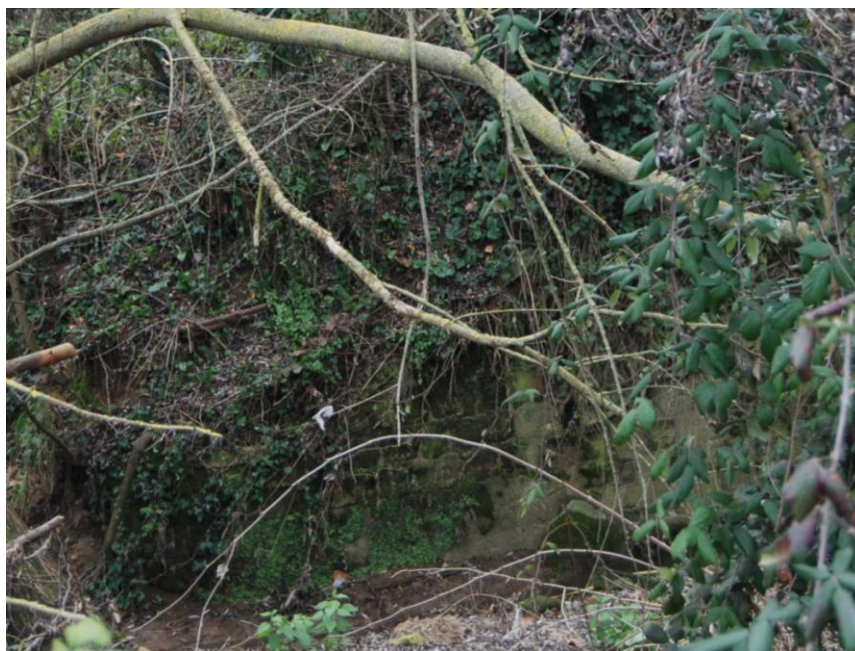
fig. 53 a. ponte di Acquatraversa. Tratto di muratura medievale lungo l'arginatura laterale E (foto autore).
