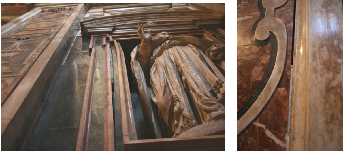
Figg. 4-5 – Cappella Aldobrandini in Santa Maria sopra Minerva. Particolari di due operazioni non idonee di riadesione delle lastre (foto dell'A.)
