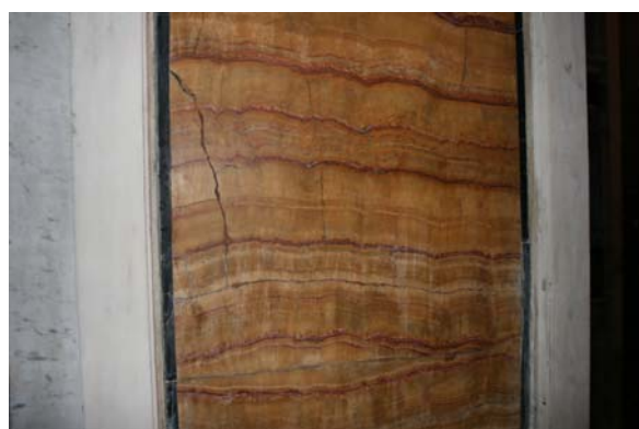
Fig. 2 – Cappella Caetani. Fessurazioni (foto dell'A.)
