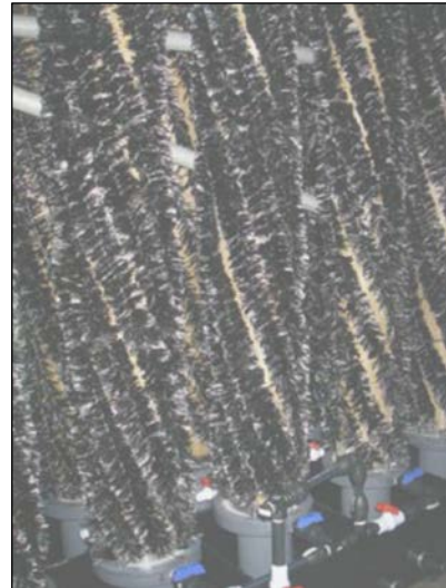
Figura 79 - Una visione d'insieme degli anodi di tutti i tubi, privi dei catodi non ancora installati.
