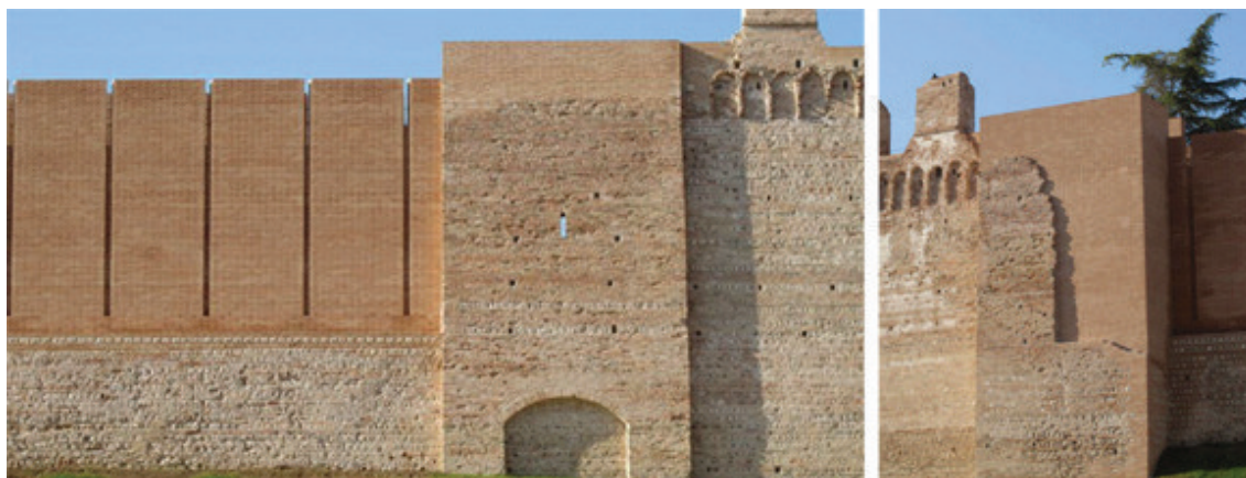
Fig. 5.23 Viste ravvicinate della muratura in corrispondenza della lacuna reintegrata (da: www.laresrestauri.it ).
