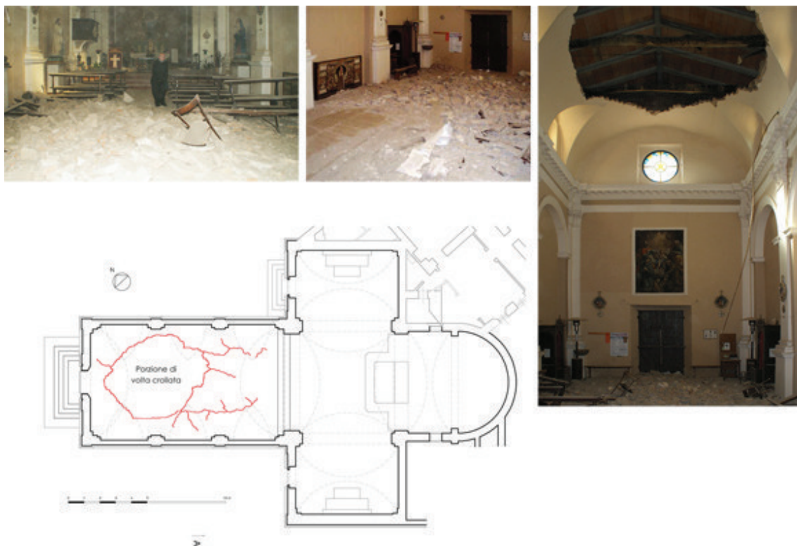
Fig. 5.75 La navata della chiesa dopo il crollo di una porzione della volta a botte avvenuto il 28 maggio 2010; a terra si notano le macerie prodotte dal crollo (foto A. Alvisi, 2010 ed elaborato di rilievo estratto dalla relazione della scrivente dal titolo Dalla conoscenza del monumento al progetto di restauro come sintesi storico-critica al convegno "Il Santuario della Madonna delle Grazie di Casticciano" organizzato dalla parrocchia di Santa Maria in Casticciano (FC) il 9 marzo 2012).
