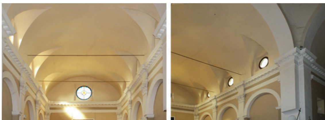
Fig. 5.74 Nello stato antecedente il crollo, la volta che sovrasta la navata del santuario è caratterizzata da un andamento a botte ribassata; su di essa si aprono sei lunette (foto M. Zanetti, 2009).
