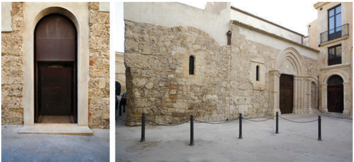
Fig. 5.56 Vista del portale in corten dall'esterno e prospetto laterale con il portale quattrocentesco (foto L. Rubino, tratte da: www.europaconcorsi.com ).
