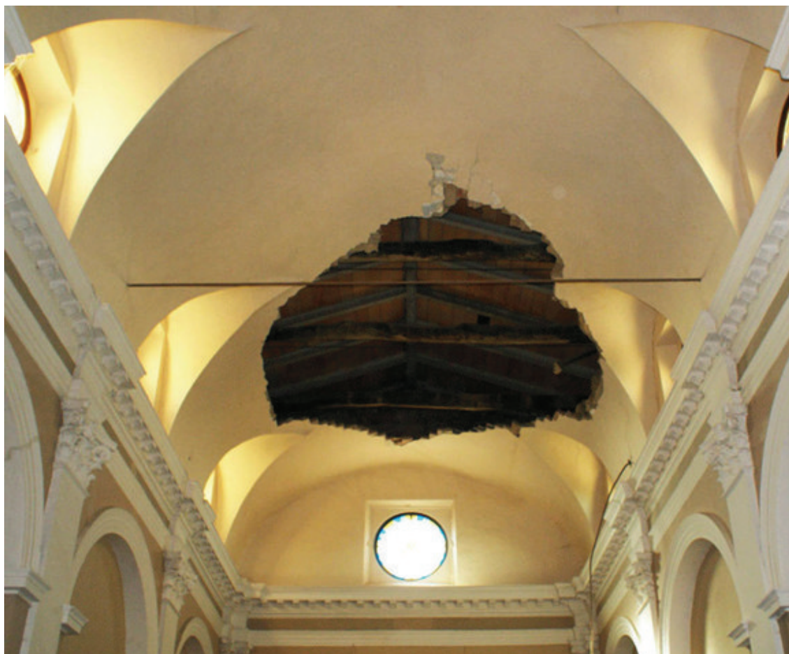
Fig. 5.71 L'interno del santuario della Madonna delle grazie di Casticciano, immediatamente dopo il crollo di una porzione della volta a botte che sovrasta la navata unica, verificatosi nel maggio 2010 (foto M. Zanetti).
