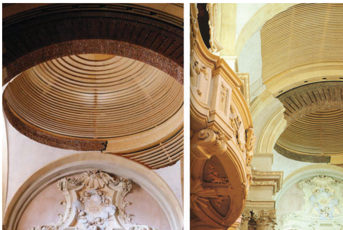
Fig. 5.31 Dettagli delle volte alla fine dei lavori (foto tratte da: P. L. CERVELLATI, Op. cit., 2000b, pp. 107 e 109).
