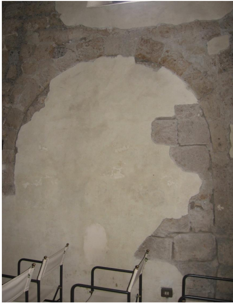
219. Nepi, chiesa di San Biagio, parete Sud, porta tamponata.
