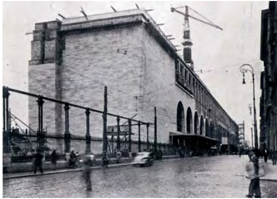
Fig. 75 – Esecuzione dei rivestimenti del fabbricato «F». La testata della Stazione Termini ancora non è stata realizzata. 1941 ca.
