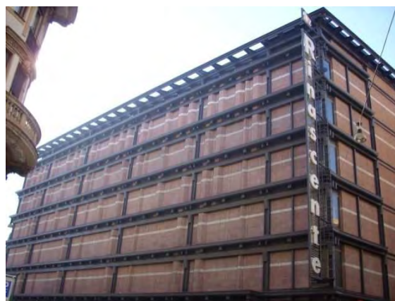
Fig. 120 – La Rinascente a Piazza Fiume – Il movimento in superficie del rivestimento esterno.
