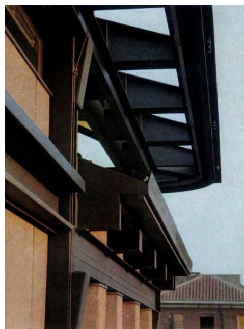
Fig. 123 – La Rinascente a Piazza Fiume – Rotaia per il carrello utile per la pulizia della facciata.
