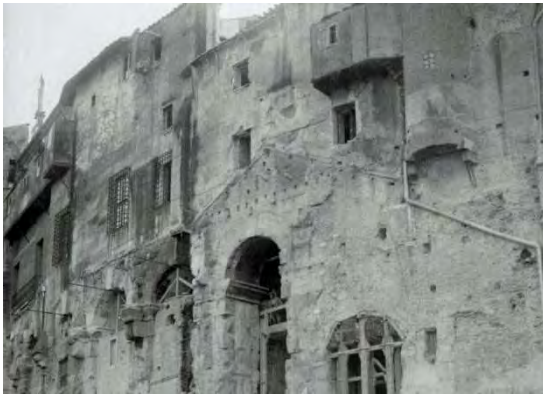
Fig. 17– Demolizione delle abitazioni costruite dentro alle arcate inferiori del Teatro di Marcello, febbraio 1928.
