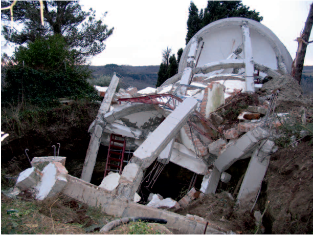
Fig. 10 - Esempio di dissesto per interferenza fra ipogei e strutture in superficie. - Example of cave roof collapse due to interaction with surface structures.
