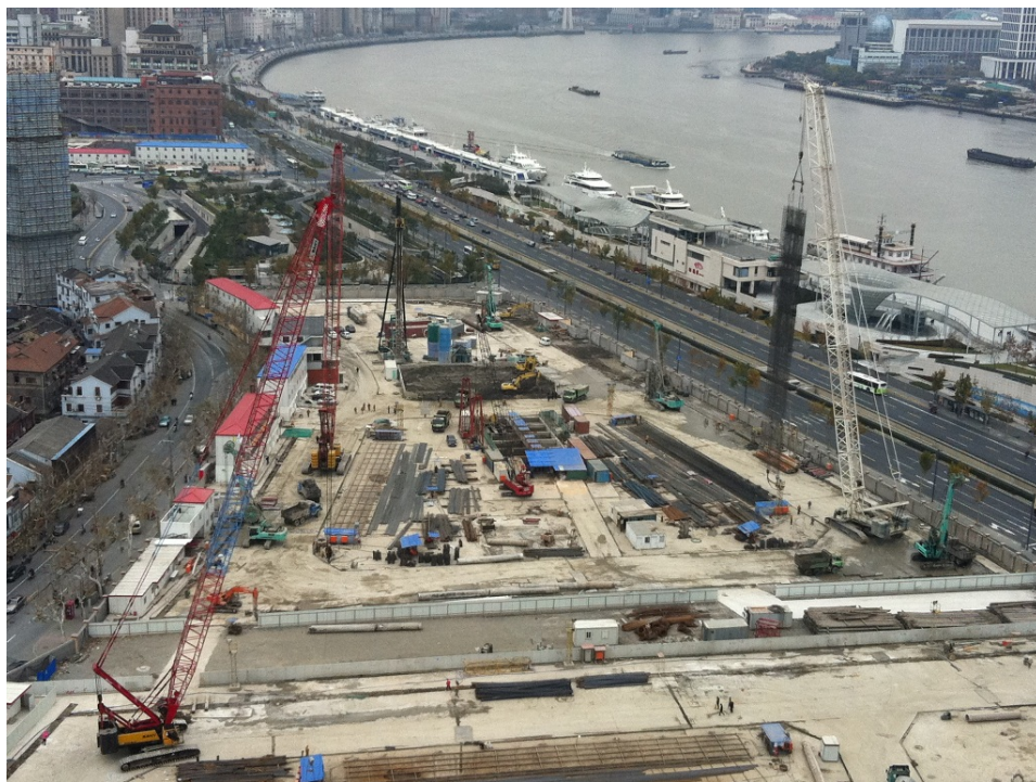
Figura 5.9: Foto del cantiere durante la realizzazione delle paratie (scattata il 29/12/2011, gentilmente concessa dall'Ing. Chen HongWei).
