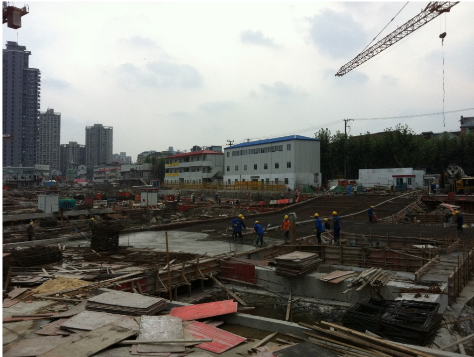
Figura 5.11: Foto del cantiere nel momento in cui viene realizzato il primo livello di supporto (scattata il 20/07/2012, gentilmente concessa dall'Ing. Chen HongWei).
