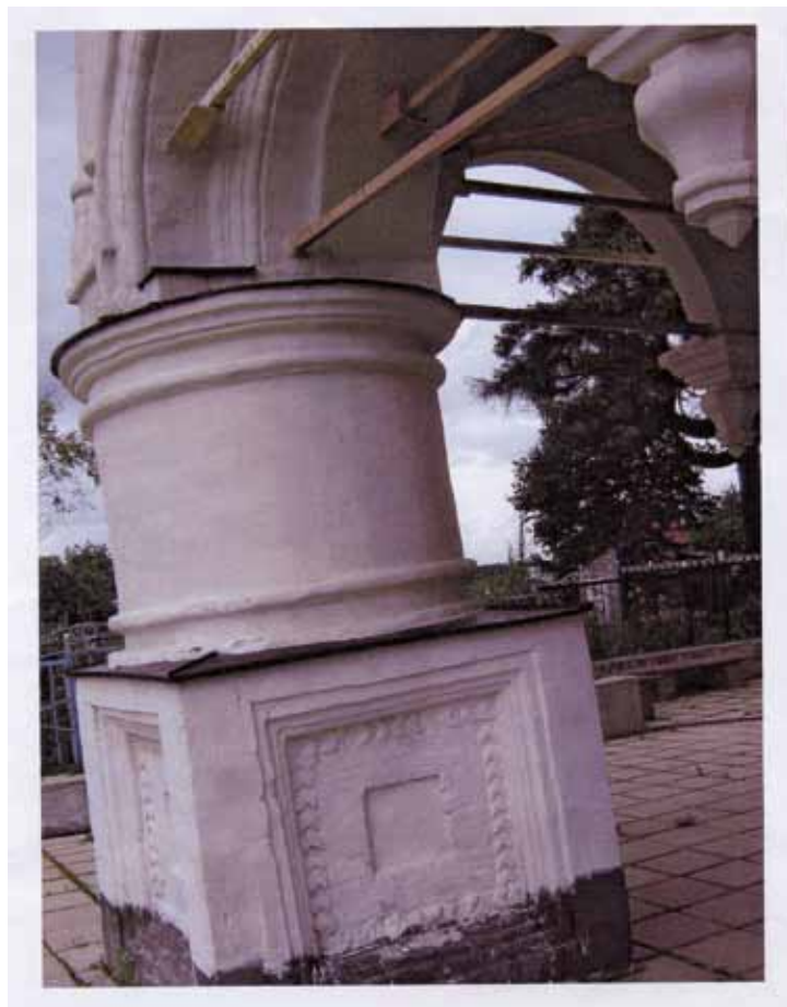
Fig. 1. Pylon's deformation. Рис. 1. Деформация пилона.
